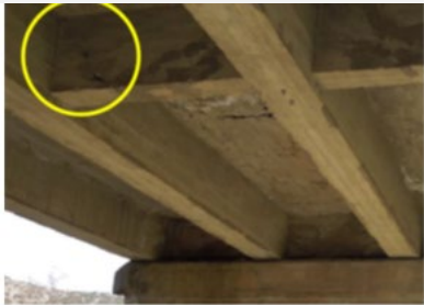
Εικόνα 10: Διαμητική αστοχία ΔΔ2 - θέση Β2
