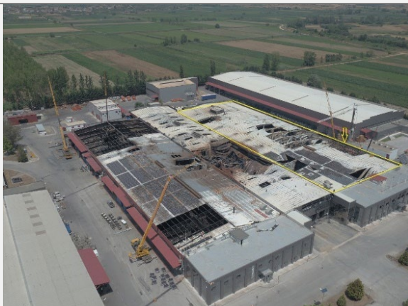
Κατεστραμμένες περιοχές των εγκαταστάσεων.
