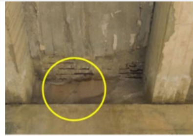
Εικόνα 13: Διαμητική αστοχία ΔΔ2 - άνοιγμα Μ1-Μ2, θέση Μ2
