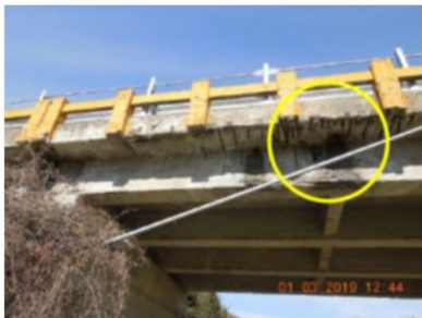
Εικόνα 11: Εκτεταμένη διάβρωση οπλισμών και αποτίναξη επικάλυψης οπλισμού - Άνοιγμα Α1Μ1
